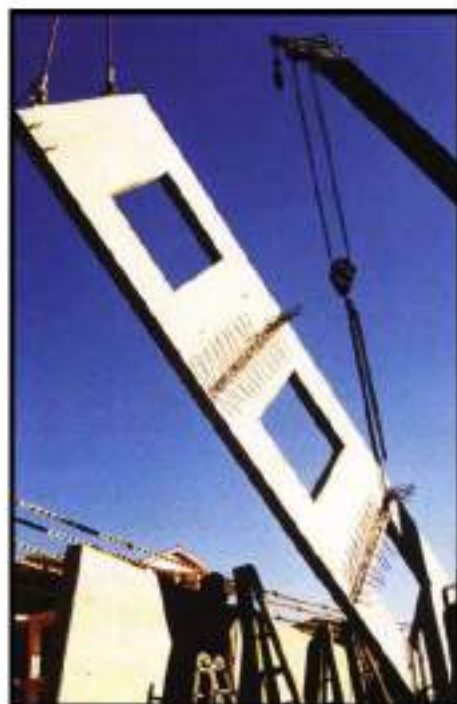
حائط خرساني بثلاث ادوار بارتفاع 9,8 متر
